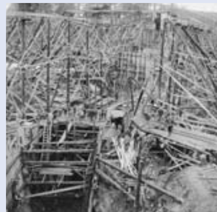
Byggandet av dammen i Gullspång 1907 kan närmast liknas vid ett storskaligt plockepinn.
